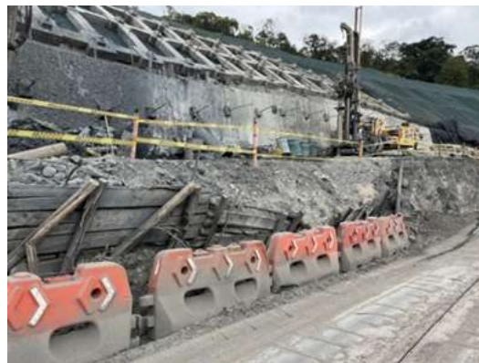
Figura 18. Estado del tramo en falla del proyecto Transversal Cusiana antes de la instalación del concreto celular.
