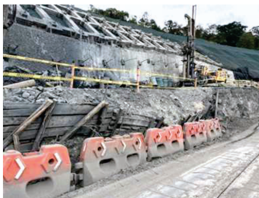
Figura 18. Estado del tramo en falla del proyecto Transversal Cusiana antes de la instalación del concreto celular.
